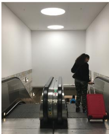
Rulltrappor ner till perrongerna är ur funktion på bilden och det händer relativt ofta. Det innebär att det blir tungt att gå i dem med tanke på steghöjden samt att hissarnas kapacitet inte räcker till för resenärer med bagage.
